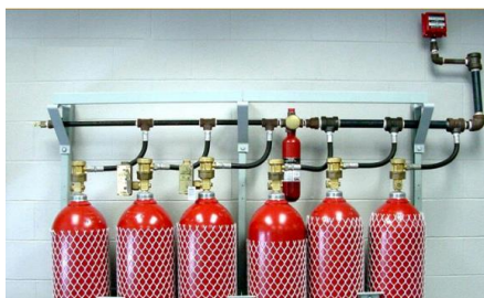
Sistema de extinción por gas CO 2 . Fuente: www.eivar.com
