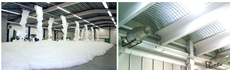
Sistema de extinción por espuma. Detalle de toberas para sistemas de alta expansión. Fuente: www.prefire.es
