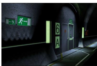
Alumbrado de emergencia en aparcamiento. Fuente: http://www.leycar.com
